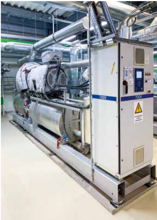
Wärmepumpe zur Rauchgaskühlung im Energiepark Dieselstraße. Foto: EVH GmbH
