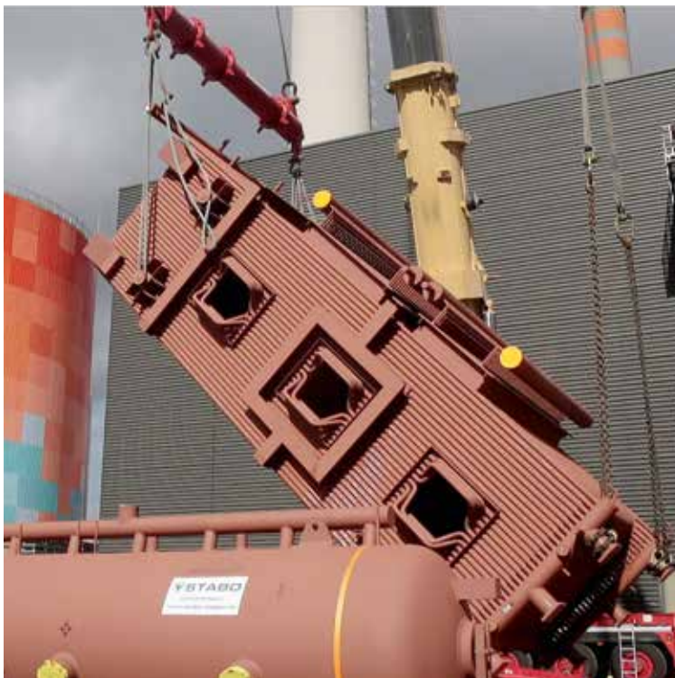
Der neue Zusatzkessel für Block A wird über das geöffnete Dach in die Anlage gehoben. Foto: Agentur Kappa, M. Sorge
